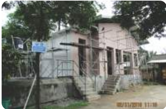
KP 3 Site SCADA Room
